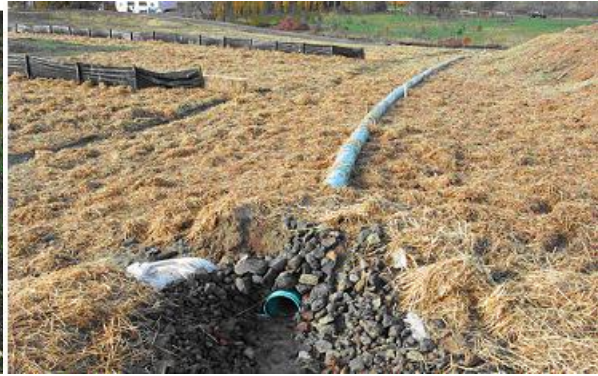
Figure 26: (d) pipe slope drain
